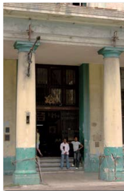
Die Spuren des Verfalls sind deutlich zu sehen.
